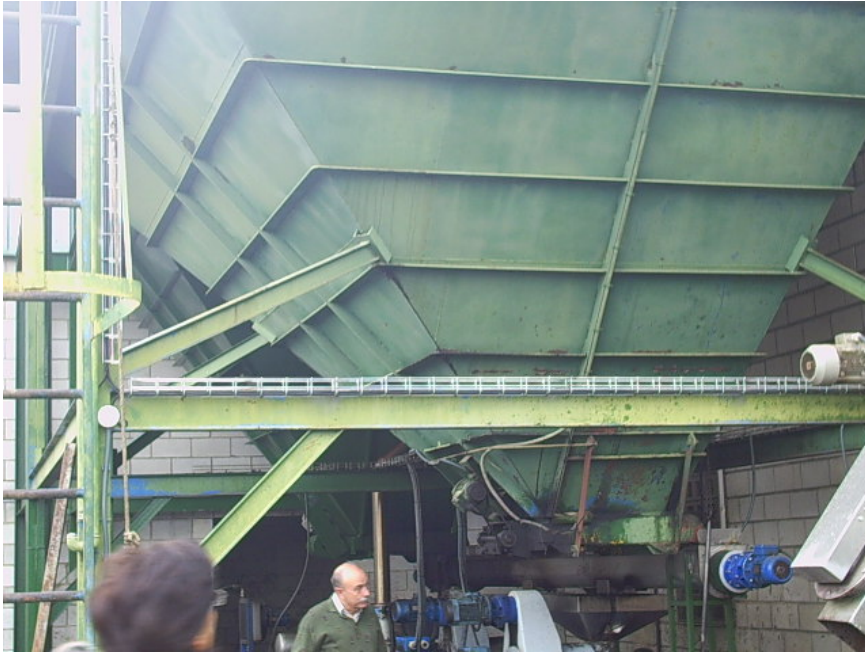
Tolva de almacenamiento
