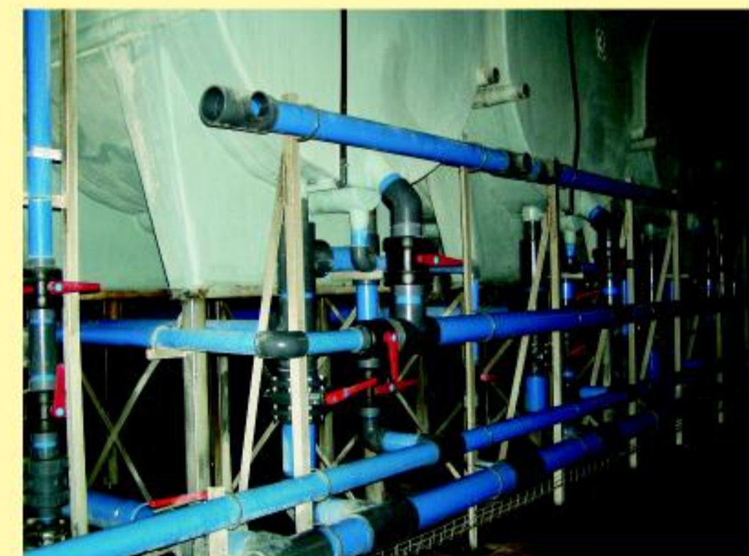
Depósitos de tratamiento (Cocción-oxidación).
